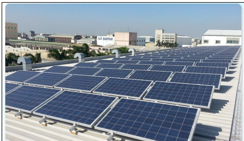
▲2014年建置福興廠頂樓建置太陽能板
